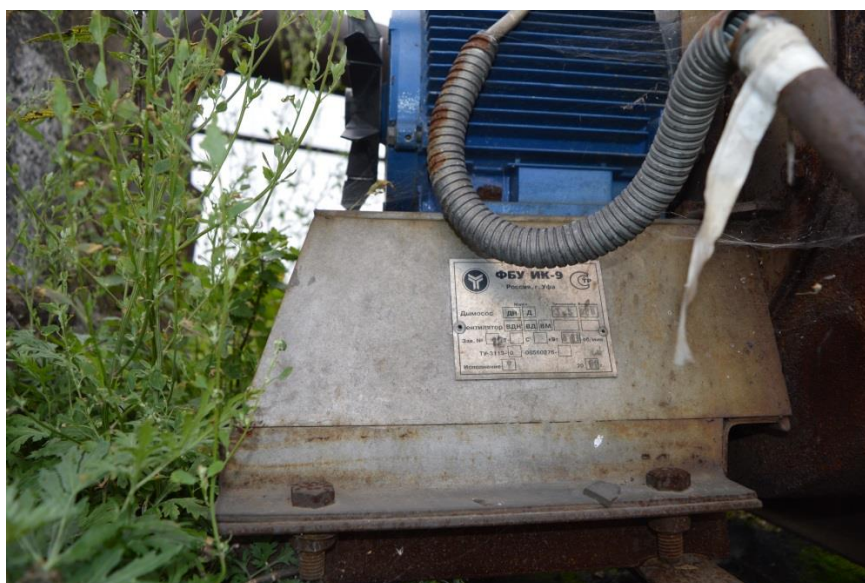
Рисунок 1.6 – Дымосос котельной с. Усть-Изес
