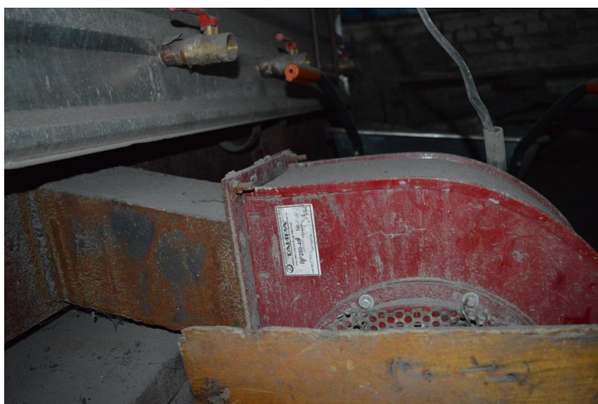
Рисунок 1.5 – Дутьевые вентиляторы котельной с. Усть-Изес
