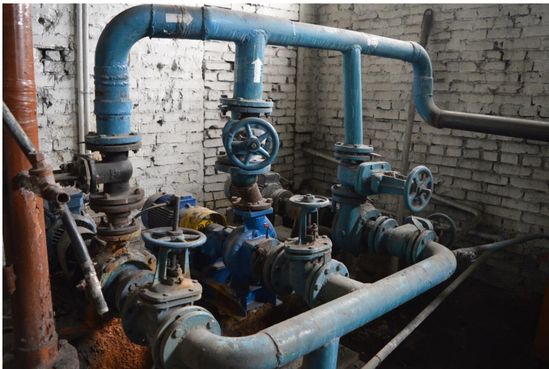
Рисунок 1.4 – Сетевые насосы котельной с. Усть-Изес
