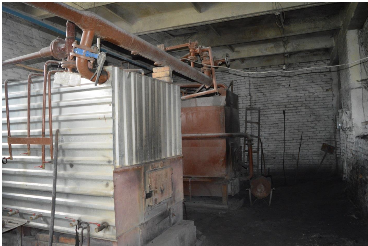
Рисунок 1.3 – Котельное оборудование, установленное на котельной с. Усть-Изес
